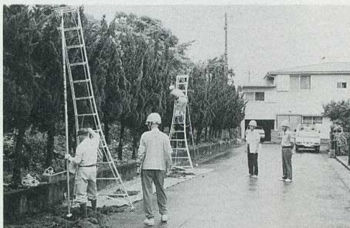
脚立設置点検！
